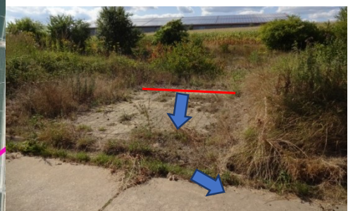
Foto 2: RRB Lehmhohl; Überlaufschwelle
